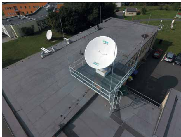
Obr. 6.10 Pohyblivá anténa pro příjem dat z polárních družic, v pozadí je vidět anténa, která byla znovu zprovozněna v roce 2015. Obě tyto antény byly instalovány v polovině 90. let 20. století.
