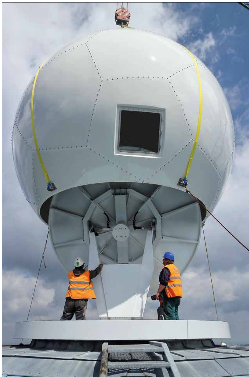
Obr. 4.10 Obnova radarové sítě CZRAD v roce 2015. Instalace nové kopule antény na radarovou věž radaru Brdy.
