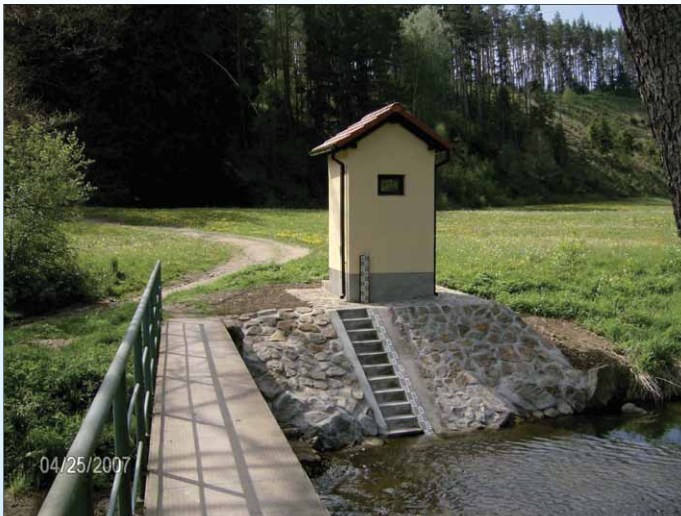
Obr. 7.3 Rekonstruovaná stanice Slovénice na Chotýšance. Stanice zůstala v červnu 2013 funkční při povodni s kulminací přesahující 100letý průtok.
