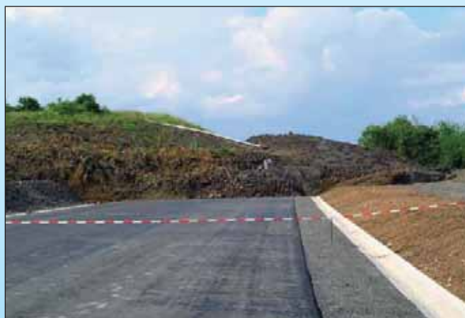
Obr. 5.7 Akumulace sesuvu na dálničním tělese D8 (Zdroj: ČGS).
