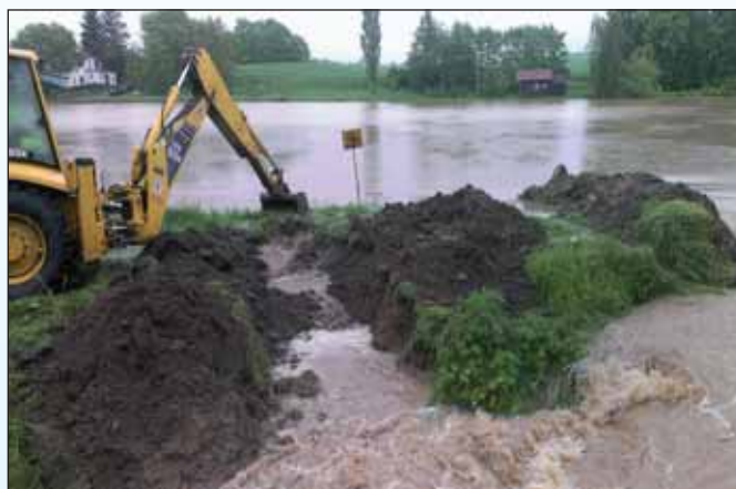
Fig. 4.13 Dredging of Lateral Dam of Chotouchovský Pond on Polepka Stream, 2 June 2013 (Source: VODNÍ DÍLA – TBD a. s.).
