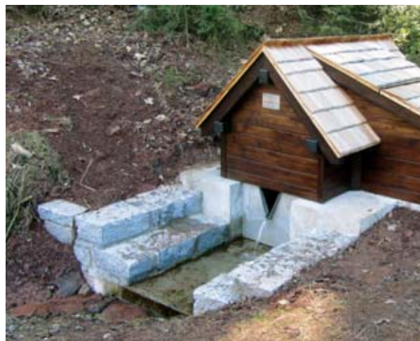
Pramen Želechy osazený trojúhelníkovým přelivem 45° s celkovým zastřešením prameniště, upraveným pro měření automatickým měřicím přístrojem.
